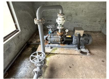
水源から貯水槽に水を送るポンプ
