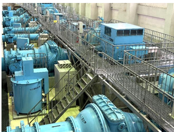
場内のポンプ設備
