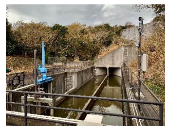
取水門の遠隔開閉装置
