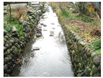
老朽化した水路
