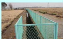
安全施設の整備
