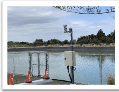
貯水池の遠隔監視カメラ・大島町
